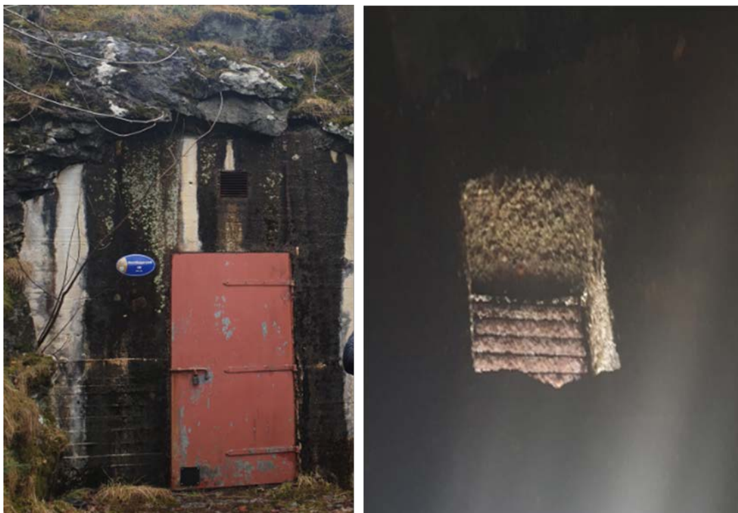
Figur 8-1. Inngangsdør (til venstre) og lufteventil uten gitter i HB168.
