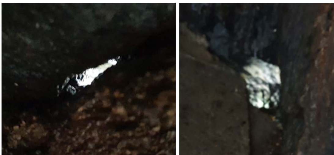
Figur 8-2. Åpninger mellom betongvegg og fjell ved inngangen til HB168.
